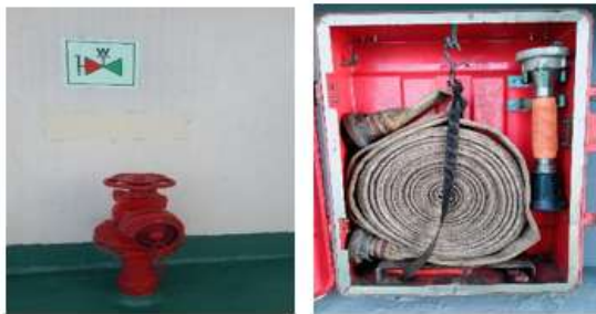
Gambar 9. Fire Hydrant dan selang
